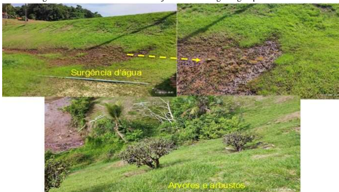
Figura 4 – Anomalias no talude de jusante – Barragem Igarapé Sete Voltas/PA
