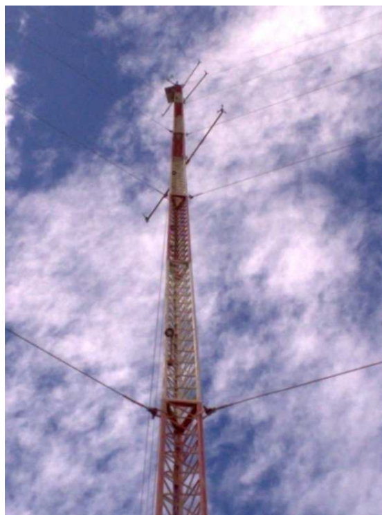
Fig.7. Torre anemométrica de 60 metros de altura instalada e comissionada para o projeto
