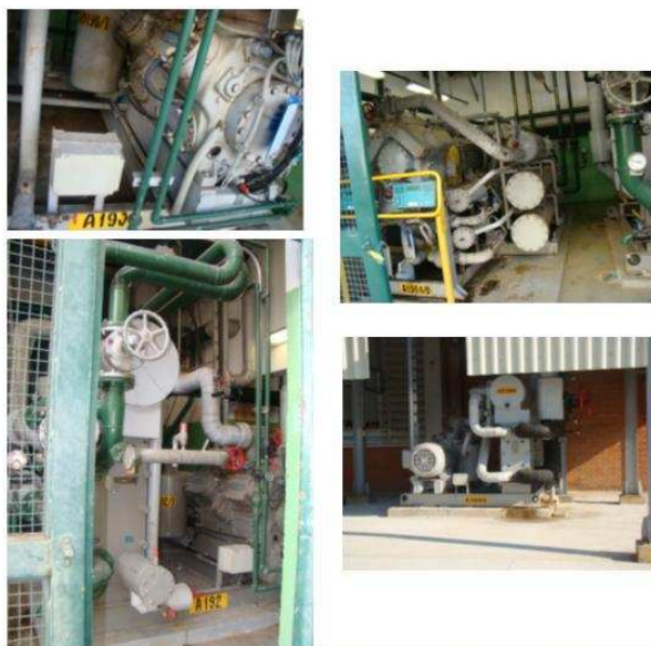
Fig. 5. Chillers A190, A192, A196A/B e A3960.
