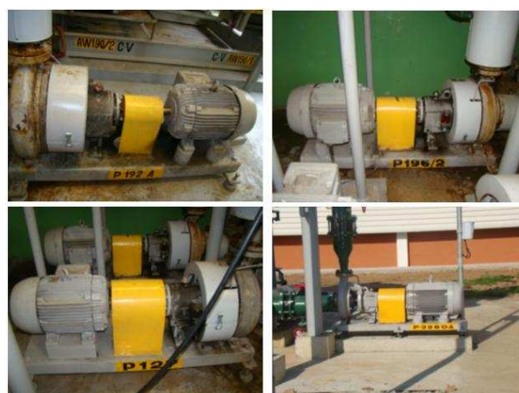
Fig. 4. Bombas P192A, P127, P196/2 e P3960.
