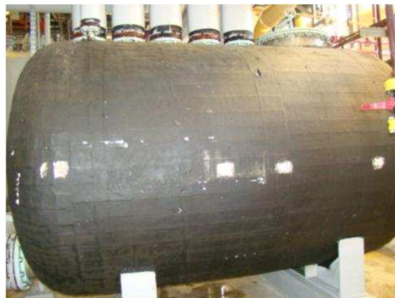
Fig. 6. Tanque de AISI304L 6,3m 3 - água a 5°C.
