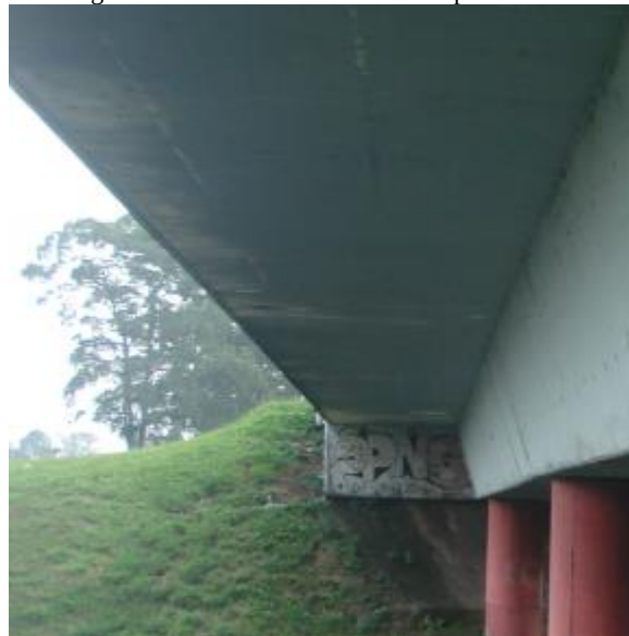
Figura 1 – Foto de vistoria realizada pelo EMEA
