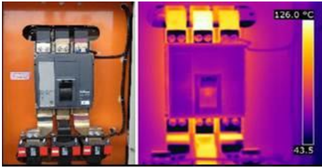
Figura 4 - Resultado de inspeção termografica
