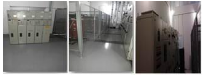
Figura 5 – Subestação da planta fabril da empresa BETA
